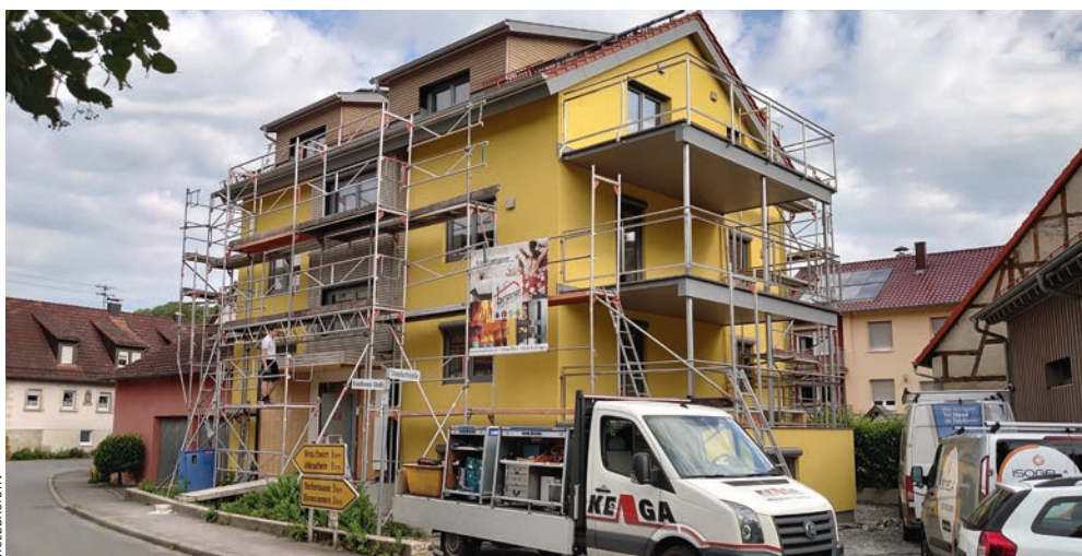
▲ Das Mehrfamilienhaus im baden-württembergischen Eberstal wurde von KEGA Holzbau innerhalb eines Jahres um zwei Wohnungen erweitert und auf KfW-40-Niveau gebracht
