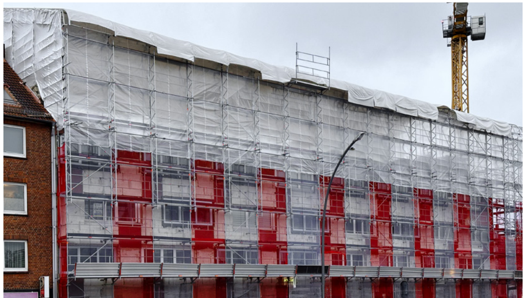
Abb. 6: Ein Gerüst mit Überdachung kommt oftmals in der Sanierung zum Einsatz (Aussteifung am Bestandsgebäude). Bei Aufstockungen muss das Dach zum Einheben von Holztafelbauelementen temporär zu öffnen sein.
