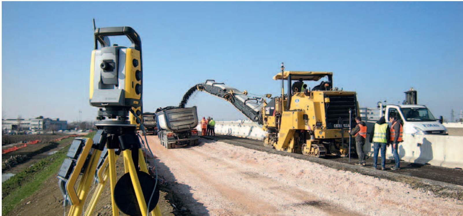
Von der Planung am 3D-Modell bis hin zu den exakt vermessenen Fräsarbeiten: Beim Ausbau der Bundesstraße B29 soll alles digital ablaufen.
