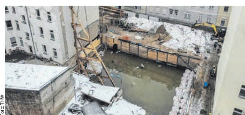
Mit Wasser vollgelaufen: THW musste Baugrube und Häuserwände in Berlin-Köpenick sichern.
