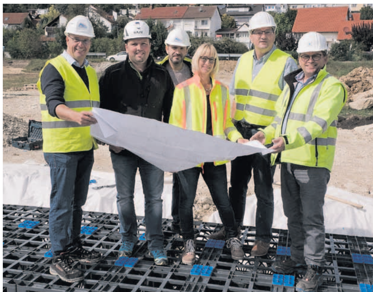
Baubesprechung vor Ort: Funke-Fachberater Gerald Barth, Bauleiter Heinrich Lang, Eduard Melcher, Technischer Kundenbetreuer von Funke, Daniela Kirschmer von der Gemeinde Elchingen, Elchingens Bürgermeister Joachim Eisenkolb und Planer Thomas Sauter (von links). Fotos (2): Funke Kunststoffe
