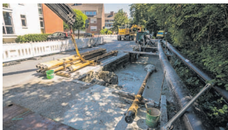
Die Aufweitungen des Bohrloches zur Startgrube hin ging von der Zielgrube aus.
