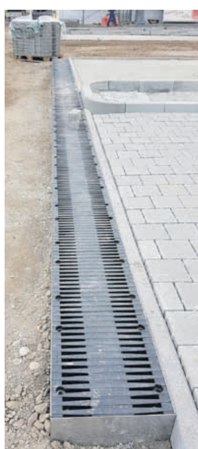
Die Einleitung ins Grundwasser erfolgt Platz einsparend direkt. Foto: BIRCO
