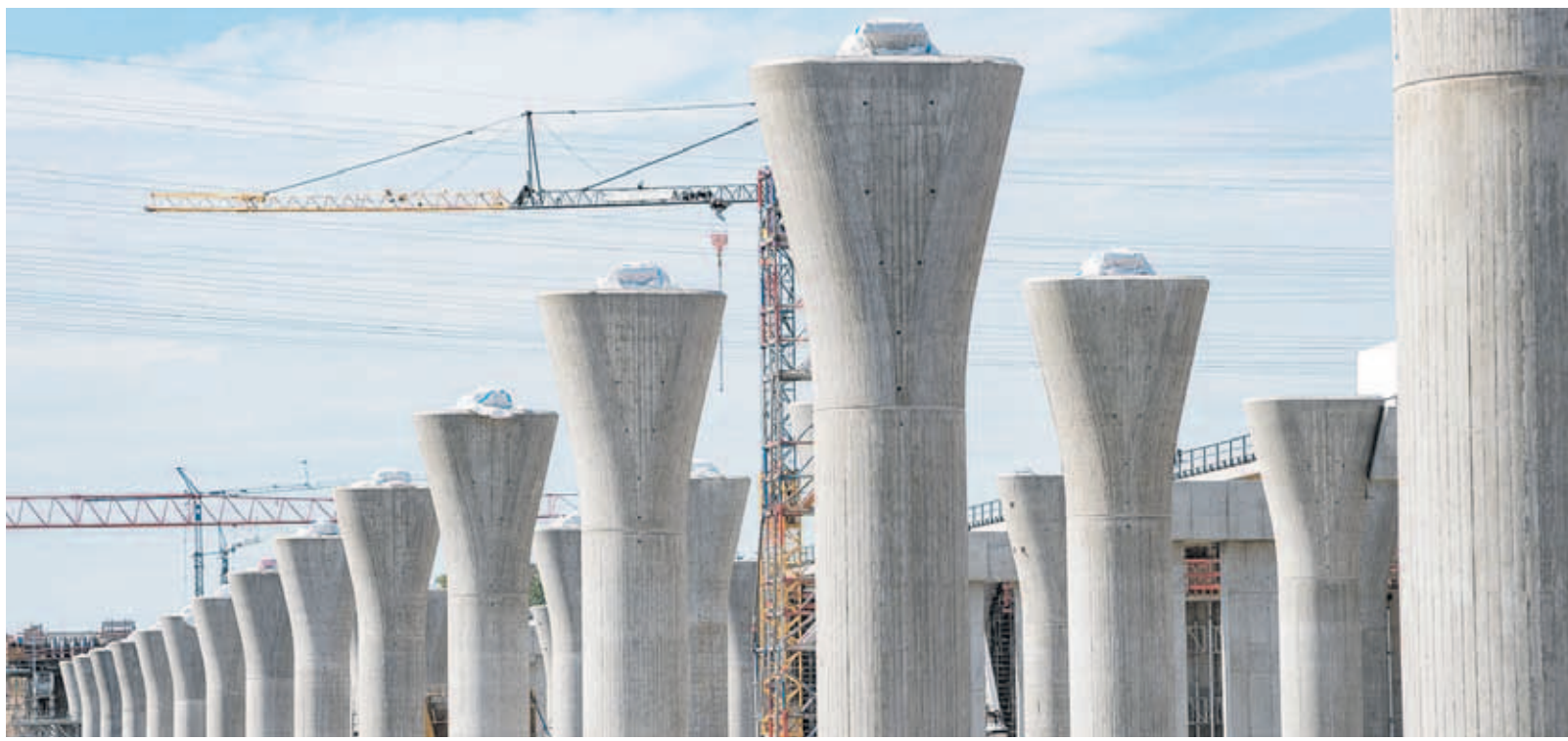
Mehr als hundert Pfeiler entstanden in Sichtbetonqualität. Der Neubau der 1,3 Kilometer langen und 16 Meter hohen Neckartalbrücke wird von einer ARGE in Angriff genommen.
