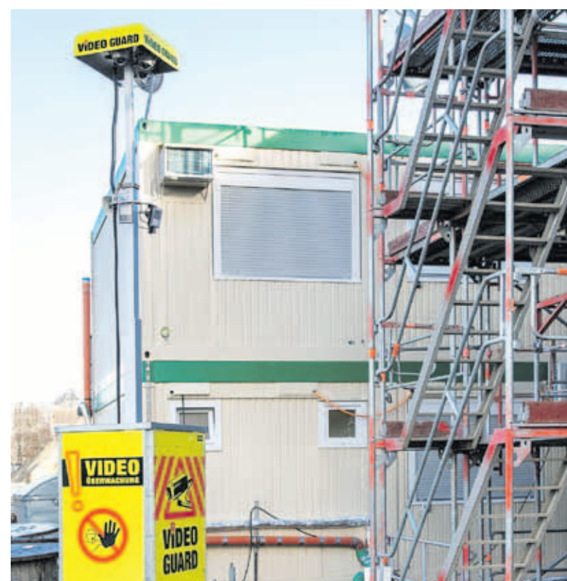
Container auf Baustellen gilt es, vor Einbrüchen zu schützen.
