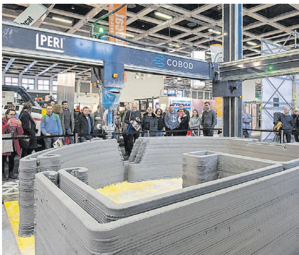
Seit 2018 entwickeln COBOD und Peri den 3D-Betondruck und mittlerweile entstehen rund um den Globus Bauwerke aus dem Drucker Foto: PERI
