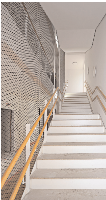
Kindgerechte Schutznetze sichern den Treppbereich.
